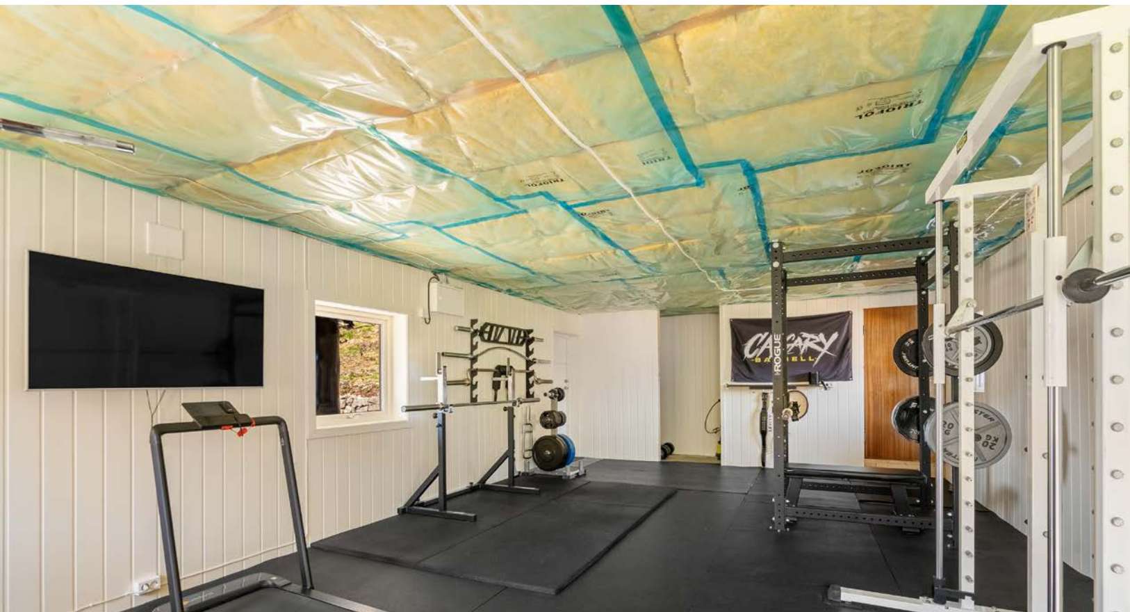
Uthus med eget sikringskap (Ikke godkjent).
