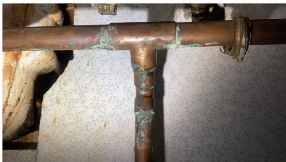
Irr på rør
