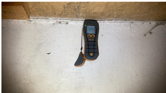
Ved enkle fuktmålinger registrerte jeg tørre verdier.
