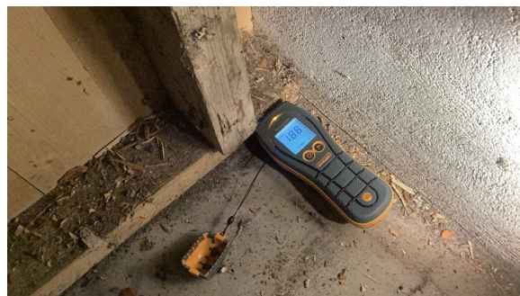
Ved fuktmåling registrerte jeg fukt.
