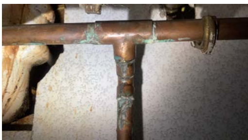
Irr på rør
