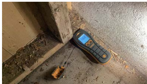
Ved fuktmåling registrerte jeg fukt.
