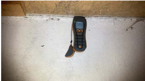
Ved enkle fuktmålinger registrerte jeg tørre verdier.
