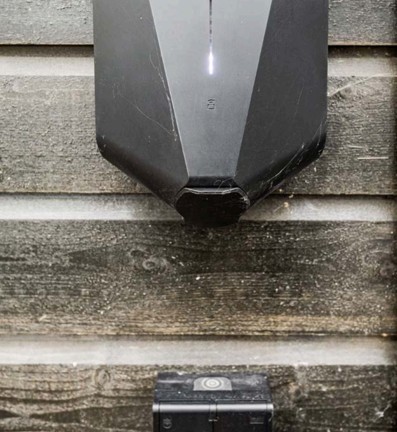
Det er montert elbil-lader og utvendig stikkontakt på husveggen.
