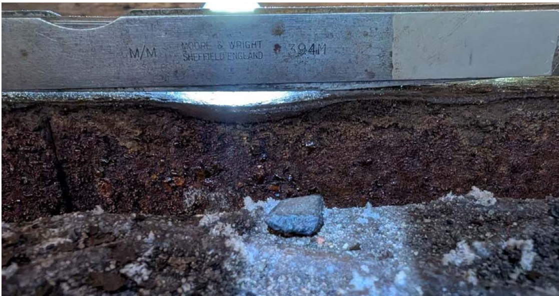
Foto 46: Lokal deformasjon over bolte hull til skinne
