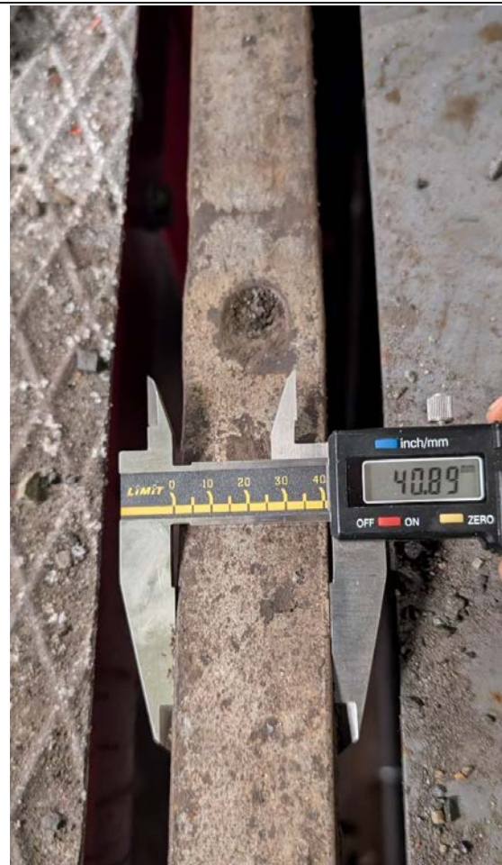
Foto 47: Bredere skinne ved lokal deformasjon rundt bolteforbindelse til skinne
