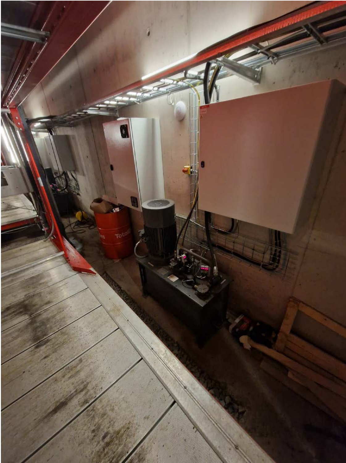
Foto 53: Maskinrom inne i parkeringsanlegg
