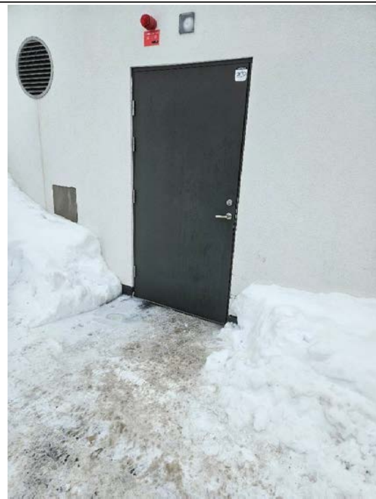
Foto 55: Dør til P2 - lav terskel, snø, is
