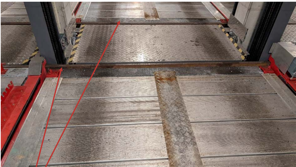
Foto 42: Skinne/bjelke horisontal forflytning, øvre nivå
