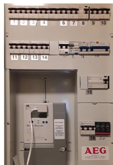
Elektrisk anlegg - [Sikringsskap med AMS-måler - Bod]
