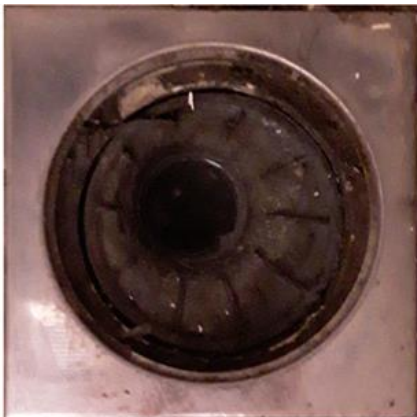
Våtrom - [Sluk - Vaskerom]
