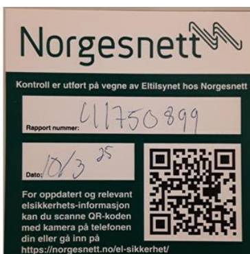
Elektrisk anlegg - [El-kontroll utført 10.03.2025]
