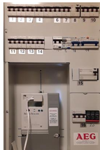
Elektrisk anlegg - [Sikringsskap med AMS-måler - Bod]
