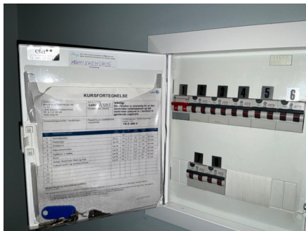
Automatsikringer i sikringsskap plassert i entre.
