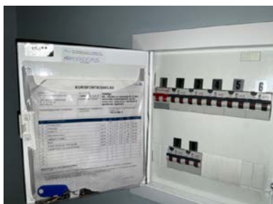
Automatsikringer i sikringsskap plassert i entre.
