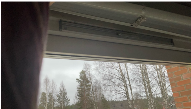
Spalteventiler i vinduskarmer.
