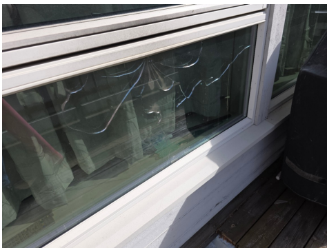
glasskade stue 1.etasje
