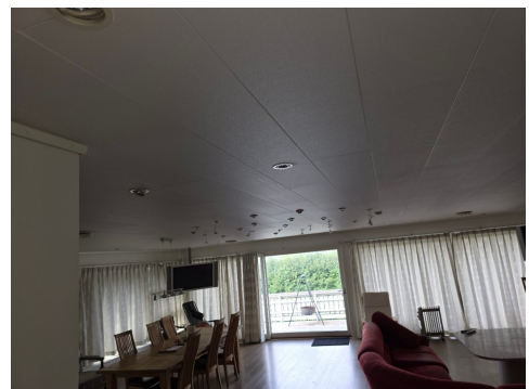
nedbøyning ved himling stue
