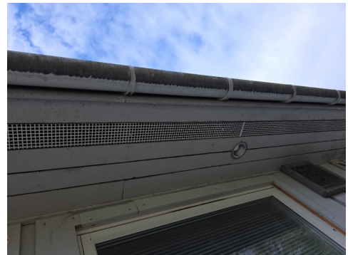
spalte med netting
