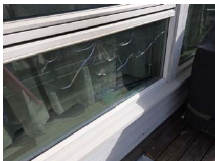
glasskade stue 1. etasje
