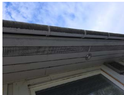
spalte med netting
