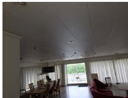
nedbøyning ved himling stue
