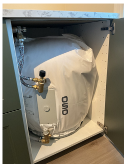
Varmtvannsbereder i kjøkkeninnredning.
