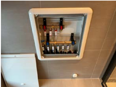
Fordelerskap er plassert på bad.
