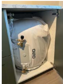
Varmtvannsbereder i kjøkkeninnredning.
