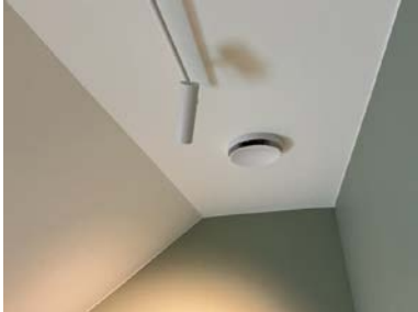
Tilluftsventil på soverom.
