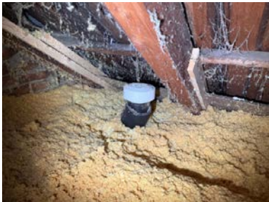
Vakuumventil på kaldtloft.
