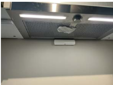
Avtrekkseffekt er testet med papir.
