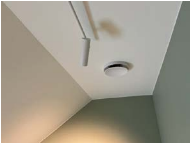
Tilluftsventil på soverom.
