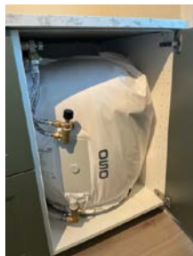
Varmtvannsbereder i kjøkkeninnredning.
