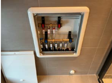
Fordelerskap er plassert på bad.
