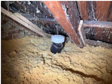
Vakuumventil på kaldtloft.
