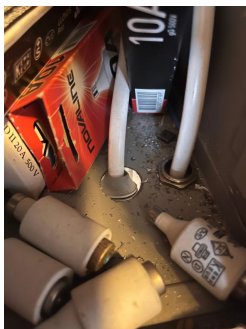
Åpning i skap som ikke er tettet
