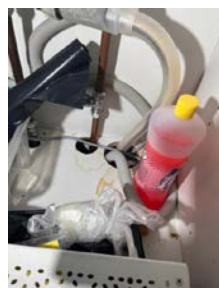
Merker etter fukt i bunn på benkeskapet.
