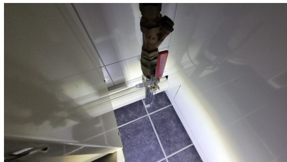
Kontroll av innvendig hovedstoppekran.
