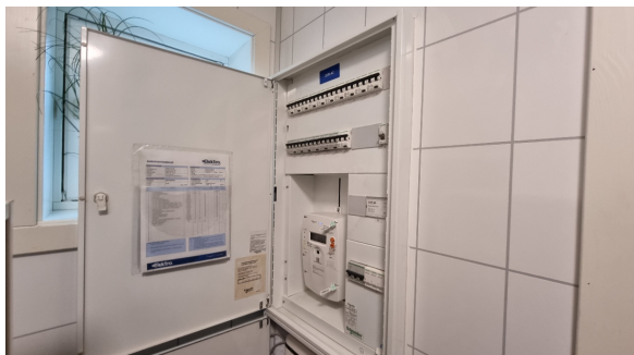
Kontroll av el-skap og kursfortegnelse.
