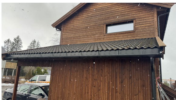
Taktekkingen har noe mose.
