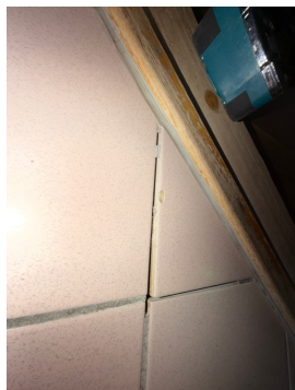
Løs flis, bom (hulrom) under flere fliser
