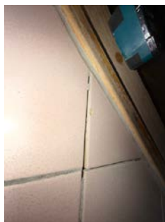
Løs flis, bom (hulrom) under flere fliser
