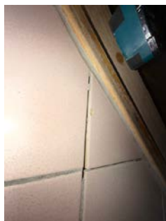
Løs flis, bom (hulrom) under flere fliser
