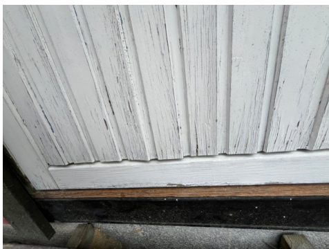
Noe sprekker og overflate slitasje.
