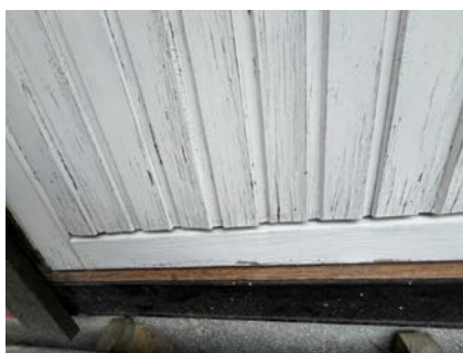
Noe sprekker og overflate slitasje.
