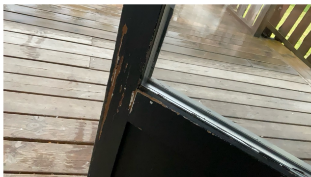
Terrassedør med avflassing.
