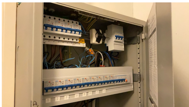
Sikringsskap med automatsikringer. Noen sikringer er ikke nummerert.
