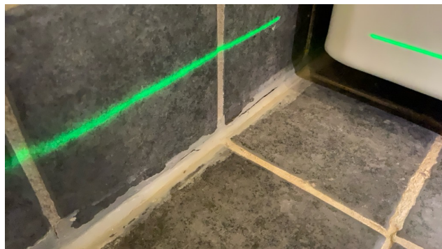
Sprekker i silikonfuger.
