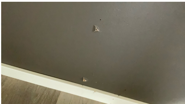
Eksempel på skade i overflate.
