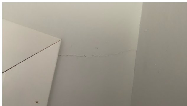
Eksempel på sprekk i overflate.
