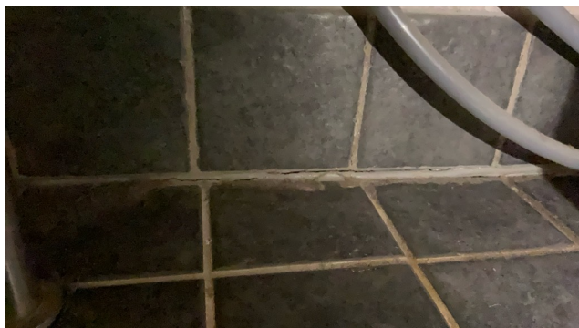
Sprekker i silikonfuger.
