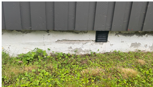
Eksempel på store riss/ sprekker i grunnmur.
