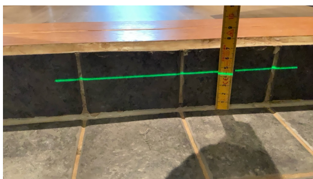
Det er målt 4,4cm på gulv ved terskel.
