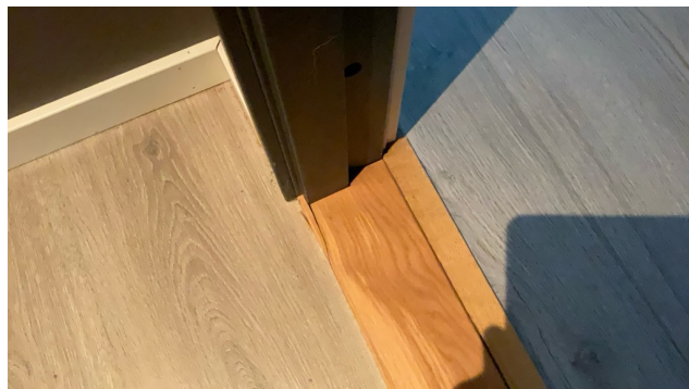
Sprekk i terskel.
