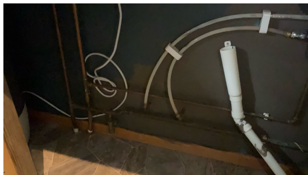
Innvendig vannledninger av kobber og noe plast.
