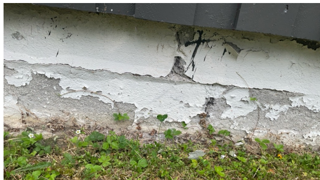
Eksempel på store riss/ sprekker i grunnmur.
