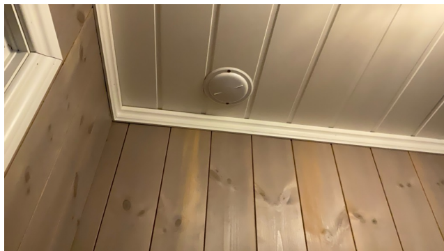
Avtreksventil i toalettrom.
