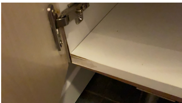
Svellskader i innredning.
