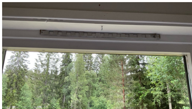
Ventiler i vinduer.
