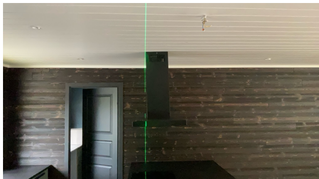
Eksempel på skjevmontert ventilator.
