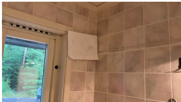
Ark henger på avtrekksventil. Bra avtrekk på bad.
