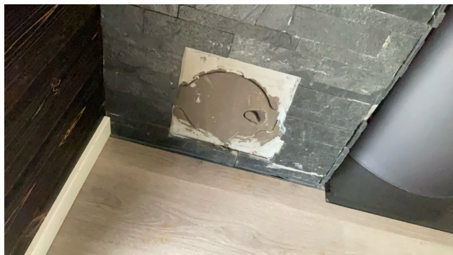
Ingen ubrennbar plate under feie/sotluke.
