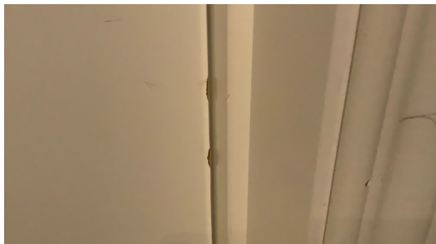
Skader i dørblad på ytterdør.
