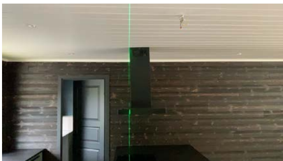
Eksempel på skjevmontert ventilator.
