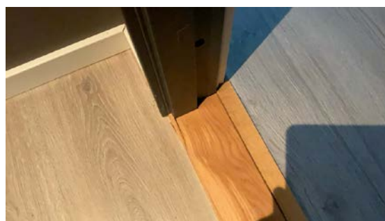
Sprekk i terskel.
