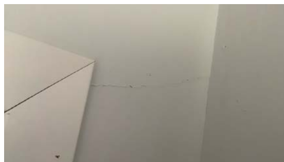
Eksempel på sprekk i overflate.
