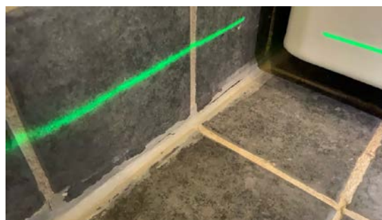
Sprekker i silikonfuger.
