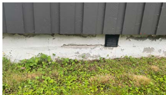
Eksempel på store riss/ sprekker i grunnmur.
