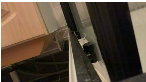
Svellskader i innredning.
