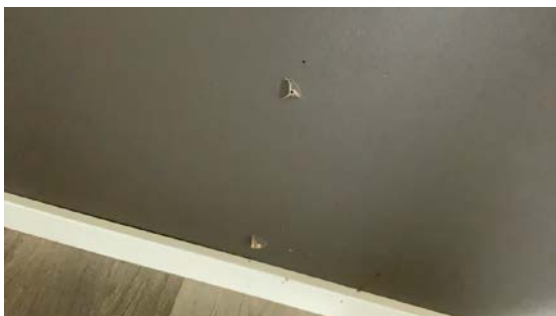
Eksempel på skade i overflate.
