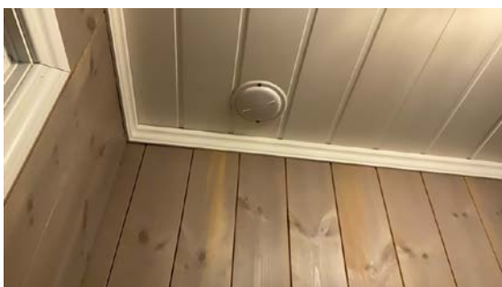
Avtreksventil i toalettrom.
