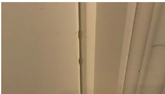
Skader i dørbblad på ytterdør.
