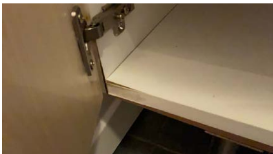
Svellskader i innredning.
