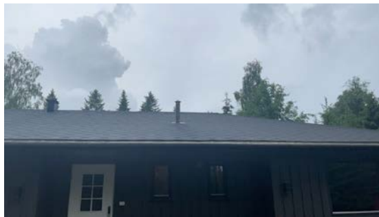
Gammel luftehett med fuktmerker i undertak på loft.
