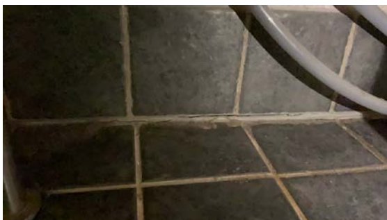
Sprekker i silikonfuger.
