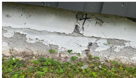
Eksempel på store riss/ sprekker i grunnmur.
