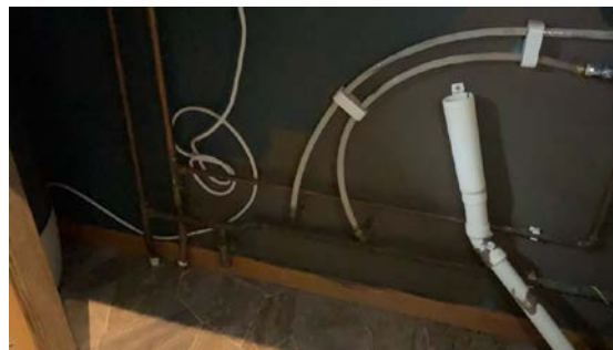
Innvendig vannledninger av kobber og noe plast.
