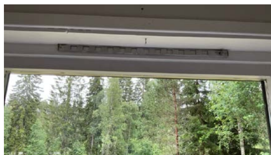
Ventiler i vinduer.
