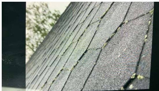
Eksempel på noe mose på taktekking.
