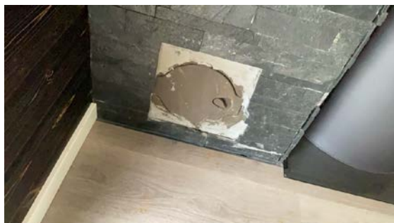
Ingen ubrennbar plate under feie/sotluke.
