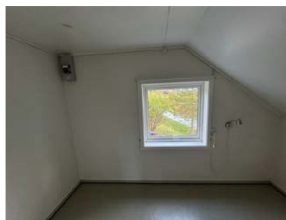
Eksempel på manglende ventilasjon.
