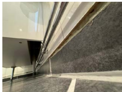
Manglende aluminiumslist og dårlig fuget.
