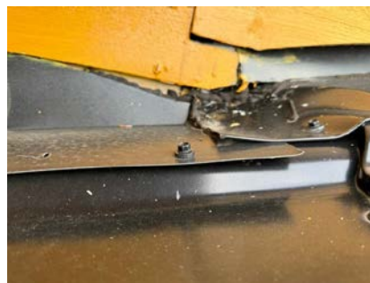
Eksempel på ufagmessig utførelse av beslag.
