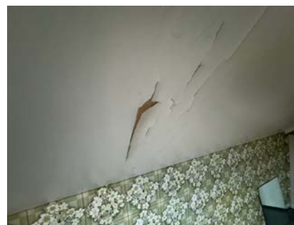
Eksempel på skader utover hva en kan forvente.
