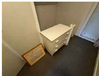
Kommode hvor det mangler rekkverk på loftet.
