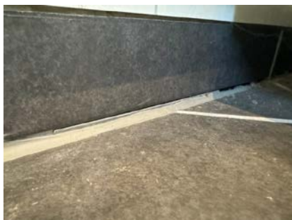
Løs fuge under sokkelflisen.
