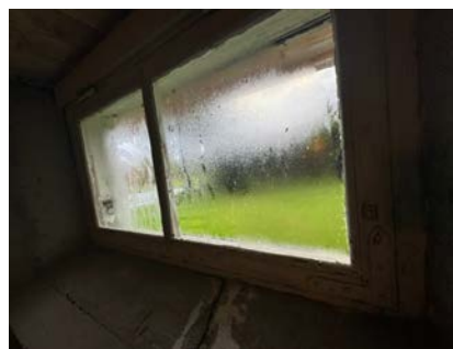
Innvendig kondensering i kjelleren.
