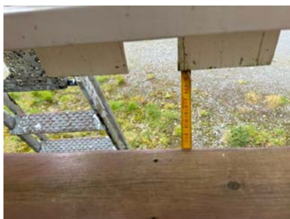
Åpninger i rekkverket.
