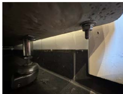
Manglende aluminiumslist og dårlig fuget.
