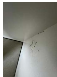
Eksempel på skader utover hva en kan forvente.
