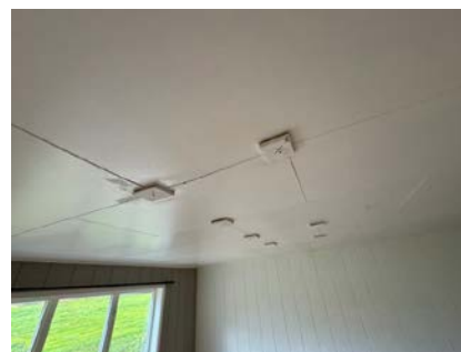
Skader i taket etter tidligere vannskade.
