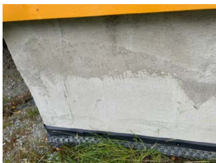
Eksempel på riss i grunnmuren.
