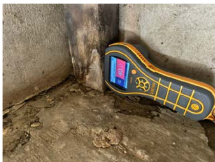
Fuktmålingen viser at treverket er mettet med vann.
