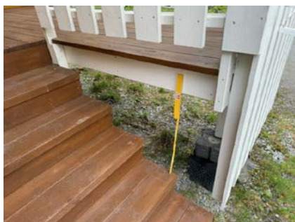
Åpninger i rekkverket.
