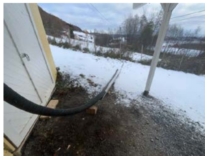
Manglende håndverksmessig utførelse på deler av arbeid
