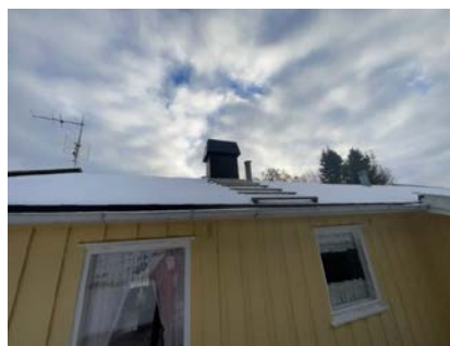
Det mangler tilfredsstillende adkomst til pipe for feier. Takstige er ikke godkjent.
