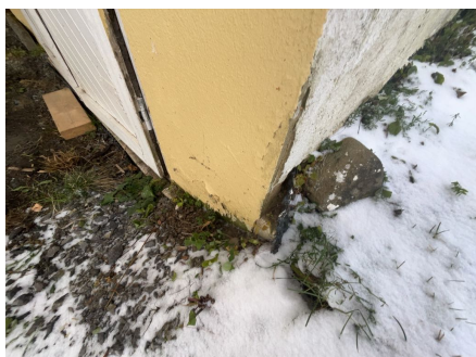
Ikke synlig fuktsikring på bolig.
