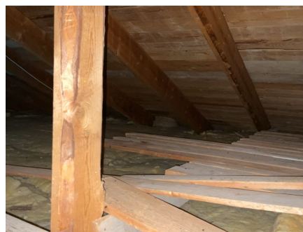
Spor etter skadedyr er registrert, ukjent omfang.
