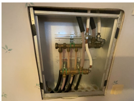
Samleskap for rør er plassert på bad i underetasjen.
