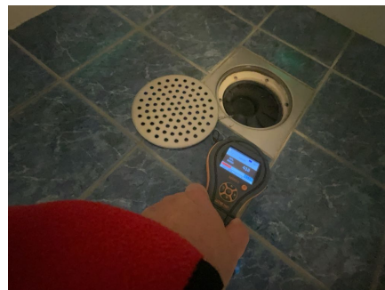
Ved enkle fuktsøk og bruk av fuktindikator registrerte jeg verdier utover hva som forventes som normalt på utsatte steder.
