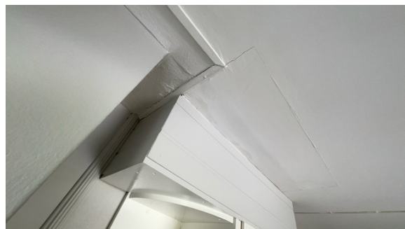
Eldre fuktmerker i kjøkkentak.
