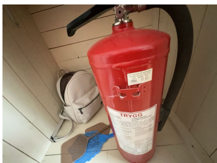
Brannslukker datert 2006, denne må kontrolleres
