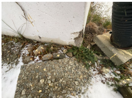
Skade på mur observert.
