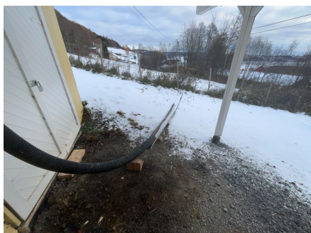
Manglende håndverksmessig utførelse på deler av arbeid
