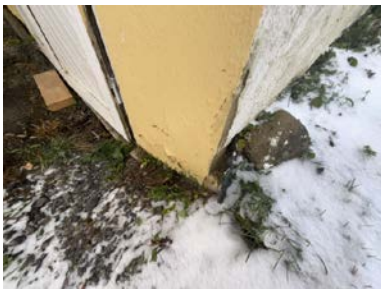
Ikke synlig fuktsikring på bolig.
