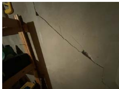
Setningsskader i kjeller observert.
