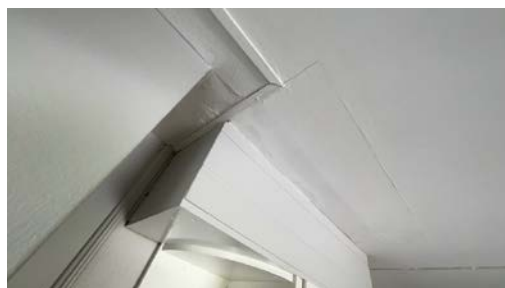
Eldre fuktmerker i kjøkkentak.
