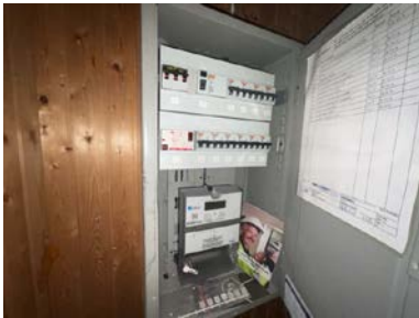
Sikringsskapet er plassert i bod i 1. etasje.
