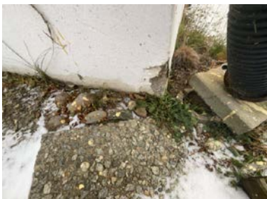
Skade på mur observert.
