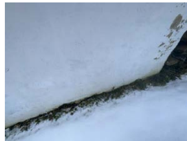
Synlig fuktsikring på bod under garasje.
