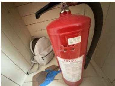
Brannslukker datert 2006, denne må kontrolleres
