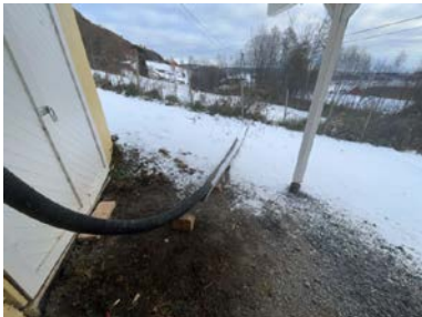
Manglende håndverksmessig utførelse på deler av arbeid
