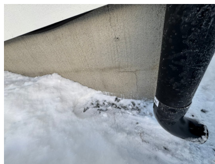
Riss i grunnmuren.
