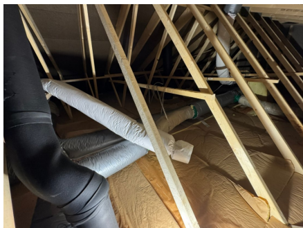
Avtrekket til isolasjonen er avsluttet på kaldloftet.
