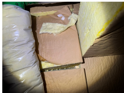
Eksempel på åpninger mellom isolasjonen.
