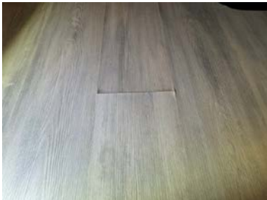
Eksempel på fuktsvelling i gulvoverflatene.
