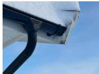
Tegn til slitasje på vindskier.
