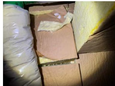
Eksempel på åpninger mellom isolasjonen.
