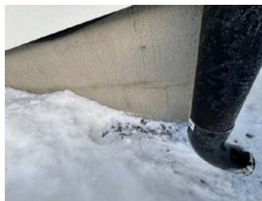
Riss i grunnmuren.
