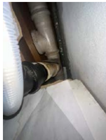
Rørstamme på kjøkken i eldre plastrør
