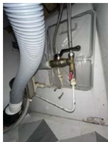
Eldre kobberør på kjøkken med stoppekraner
