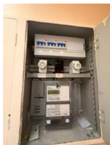
Sikringsskap med skru/automatsikringer.
