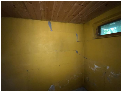
Synlige setningsskader på grunnmur.
