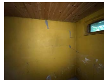
Synlige setningsskader på grunnmur.
