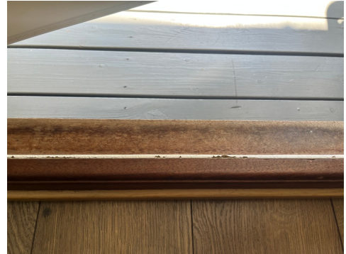
Tetningslist bør skiftes.
