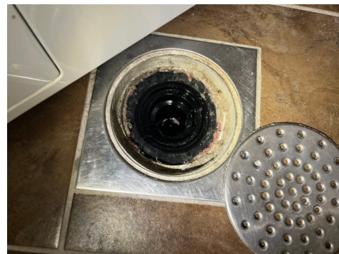
Sluk på vaskerom.
