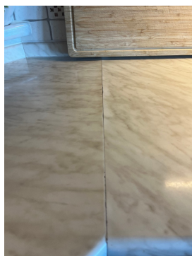
Skjør benkeplate har noe svelling.
