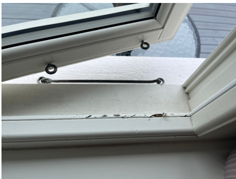
Tetningslist bør skiftes.
