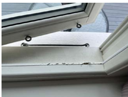
Tetningslist bør skiftes.
