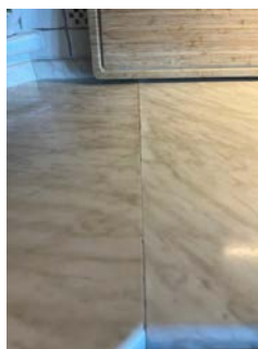
Skjør benkeplate har noe svelling.
