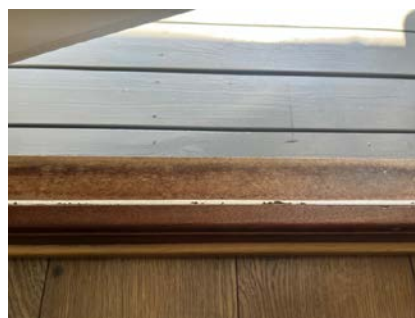
Tetningslist bør skiftes.
