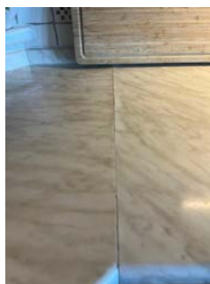
Skjør benkeplate har noe svelling.
