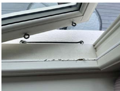
Tetningslist bør skiftes.
