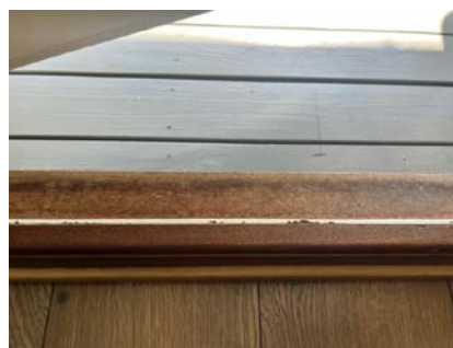
Tetningslist bør skiftes.
