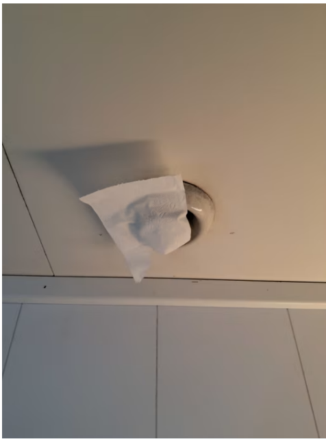
Avtrekkseffekten er testet med papir.
