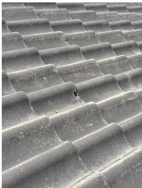
Det registreres enkelte skader på takstein.
