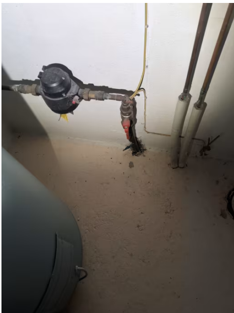
Hovedstoppekran er plassert i kjeller.
