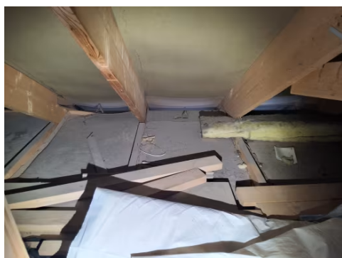
Kaldtloft har synlig lufting i raft.
