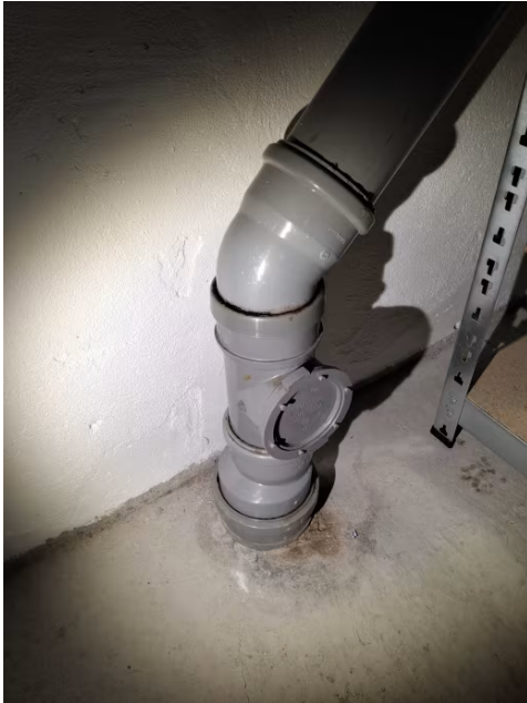
Stakeluke er plassert i kjeller.
