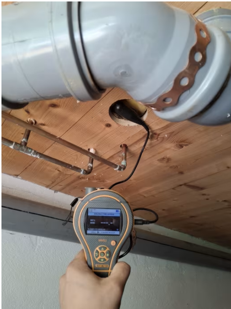
Bilde fra fuktmåling i etasjeskille ved sluk.
