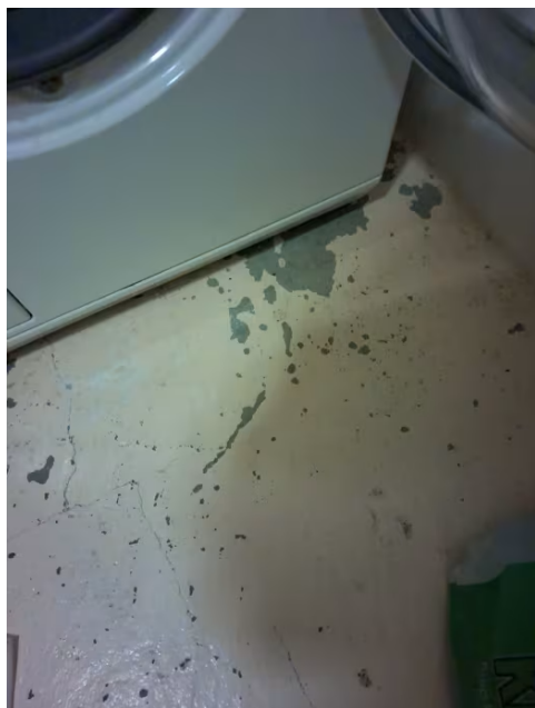
Riss i og avflasket maling på gulv.
