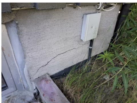
Det registreres stedvis riss/pussavskaling på grunnmuren.
