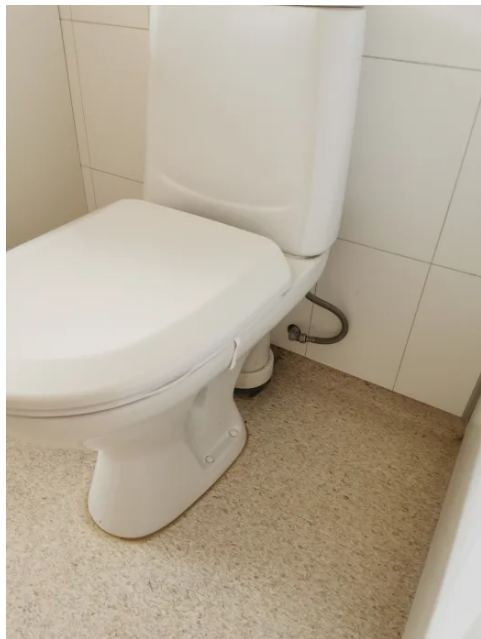
Rørgjennomføring til toalett er ikke tett.
