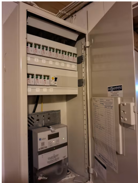
Sikringsskap med automatsikringer.
