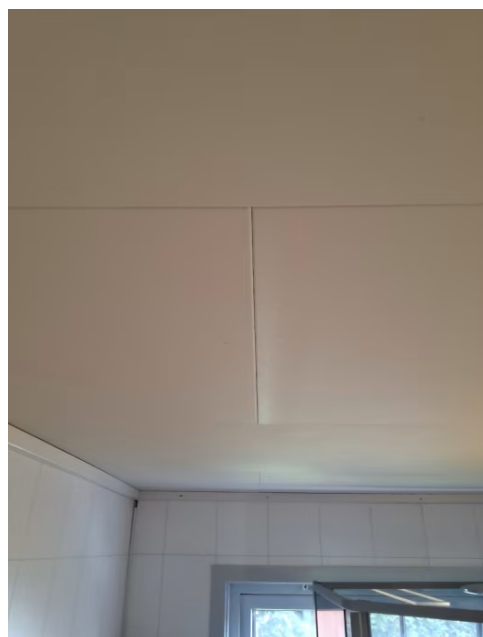
Svelleskader i himlingsplater.
