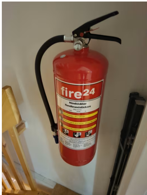
Brannslukningsapparat er plassert i trappegang.
