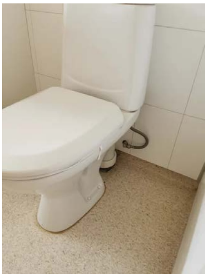
Rørgjennomføring til toalett er ikke tettet.
