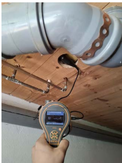
Bilde fra fuktmåling i etasjeskille ved sluk.
