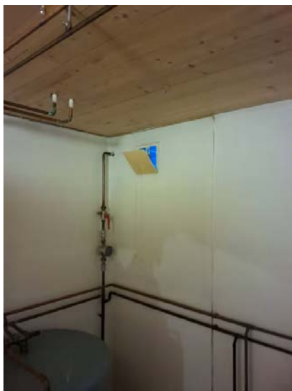
Rommet er ventilert med klaffventiler på yttervegg.
