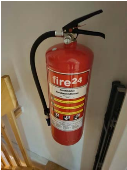
Brannslukningsapparat er plassert i trappegang.
