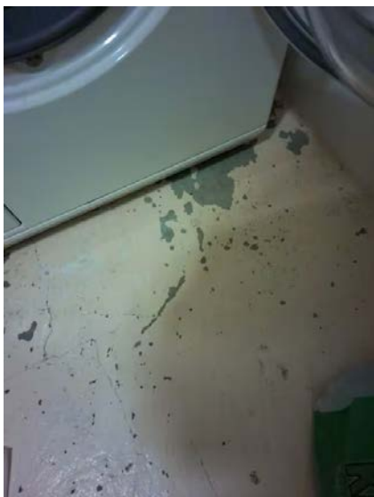
Riss i og avflasket maling på gulv.
