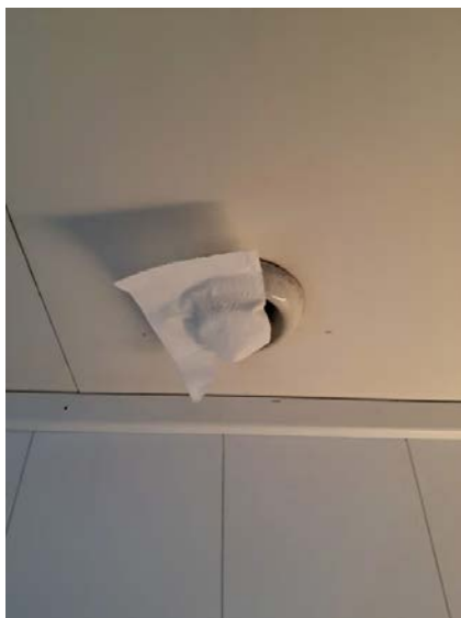
Avtrekkseffekten er testet med papir.
