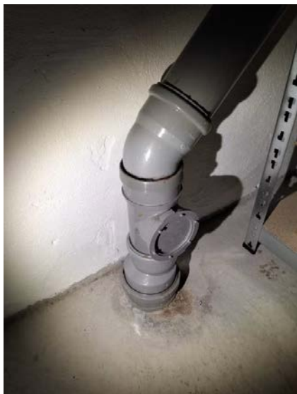
Stakeluke er plassert i kjeller.
