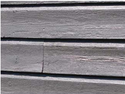
Liggende kledning i gavlvegg på østsiden er stedvis værslitt.
