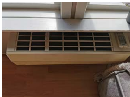
Vegghengt varmepumpe under vindu i stue.
