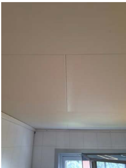
Svelleskader i himlingsplater.
