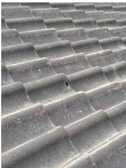
Det registreres enkelte skader på takstein.
