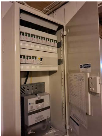
Sikringsskap med automatsikringer.
