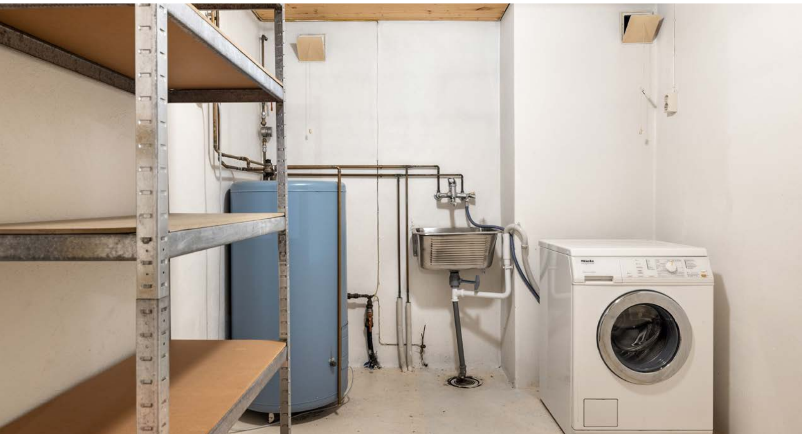
Enkelt vaskerom i kjeller med opplegg for vaskemaskin og utslagsvask.
