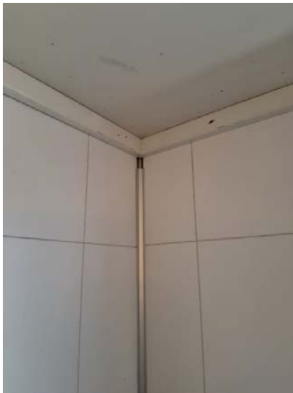
Hjørnelister er ikke montert i henhold til monteringsanvisning.
