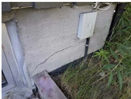
Det registreres stedvis riss/pussavskaling på grunnmuren.
