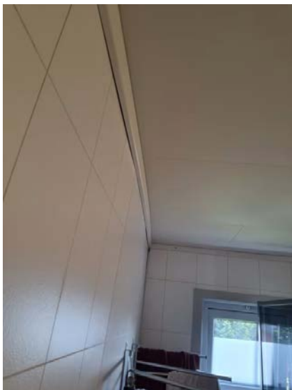
Det registreres kul på baderomsplater.
