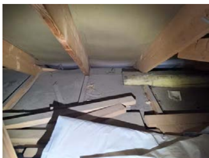
Kaldtloft har synlig lufting i raft.
