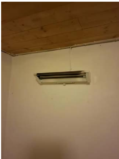
Rommet er oppvarmet med stråleovn.
