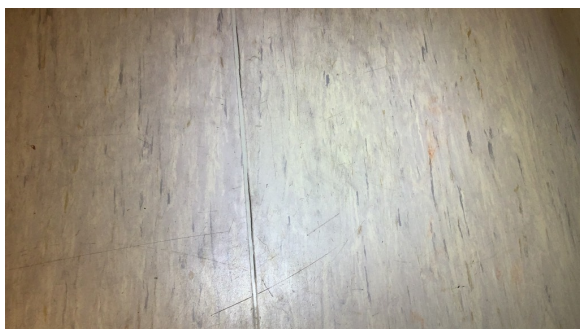
Eksempel på glipper i sveiseskjøt.
