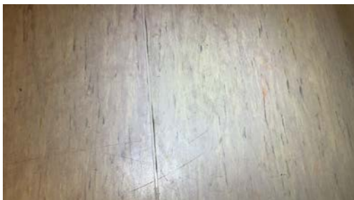
Eksempel på glipper i sveiseskjøt.
