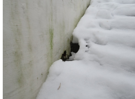
Avskalling av mur på terrasse-siden.
