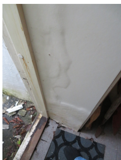
Div. fuktskader på boddør på terrassside.
