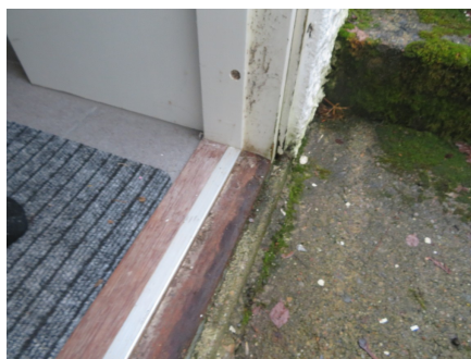
Skade/slitasje på dør på inngangssiden.
