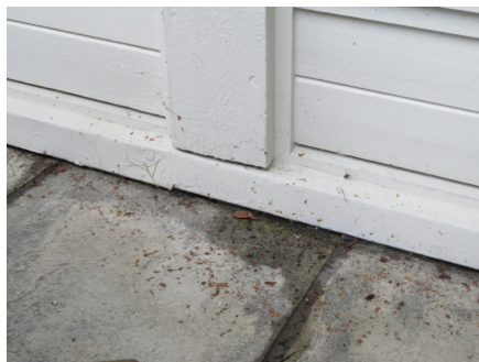
Lite avstand fra terrasse og til treverk. Ukjent løsning med membran.
