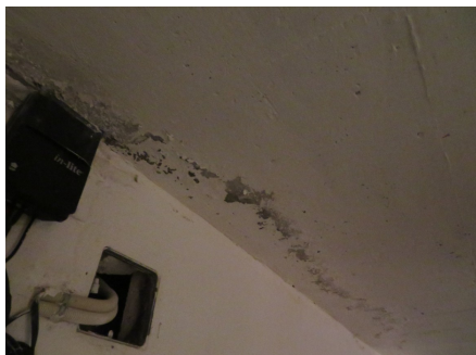
Fukt i tak innvendig i bod under terrasse.
