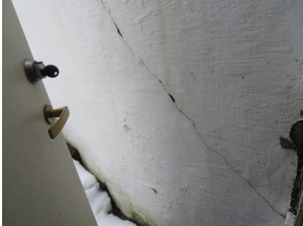
Riss i mur i trapp til kjeller på terrasse-siden..
