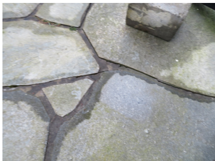
Sprekker i fuger og løse heller.
