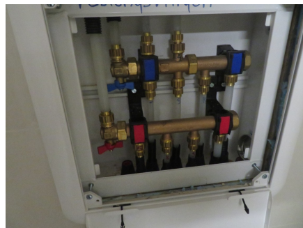
Fordelerskap i kjeller.
