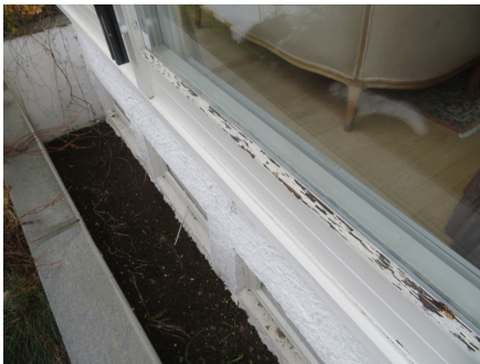
Utvendig brukslitasje på vinduer.
