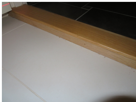
Det er ikke kjent om gulvmembran er ført opp på dørterskel.
