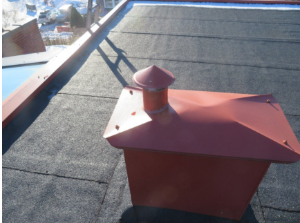
Luftehatt med lufting av avløp.
