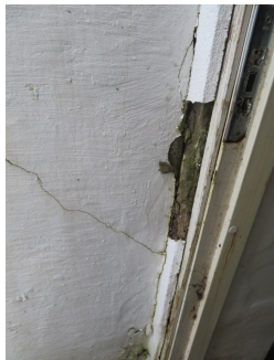
Avskalling av mur på terrasse-siden.
