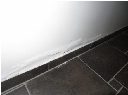
Fukt/buling på vegg i gang i kjeller.
