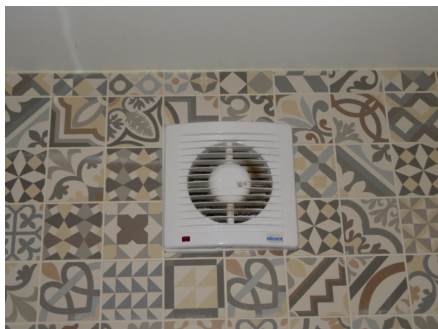
Avtrekk fra bad via ventil i yttervegg.
