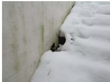
Avskalling av mur på terrasse-siden.
