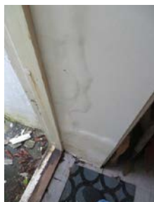
Div. fuktskader på boddør på terrassside.
