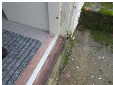
Skade/slitasje på dør på inngangssiden.
