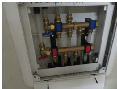
Fordelerskap i kjeller.
