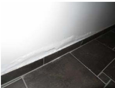
Fukt/buling på vegg i gang i kjeller.
