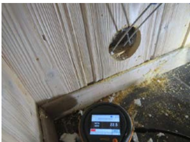
Fukt registrert i utforet vegg i peisestue.
