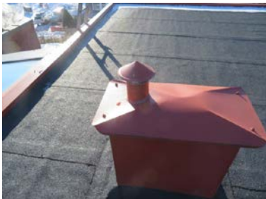
Luftehatt med lufting av avløp.
