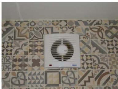
Avtrekk fra bad via ventil i yttervegg.
