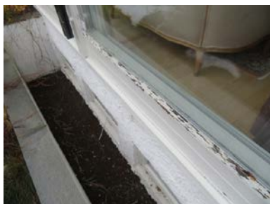
Utvendig brukslitasje på vinduer.
