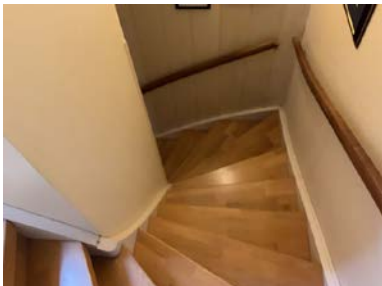
Manglende håndløper på vegg i trappeløp.
