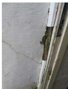
Avskalling av mur på terrasse-siden.
