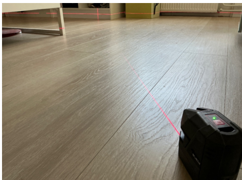
Nivellering soverom, avvik ca. 10-20 mm
