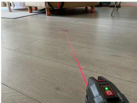
Nivellering stue, avvik ca. 30 mm gjennom hele rommet
