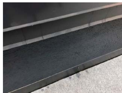
Lekkasje v/beslag under vindu
