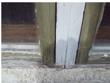
Bærer preg av alder og slitasje.
