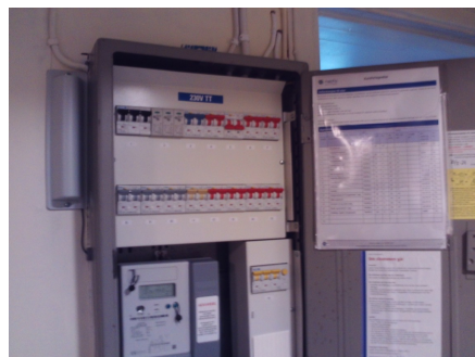
Sikringsskapet er plassert i ene boden.
