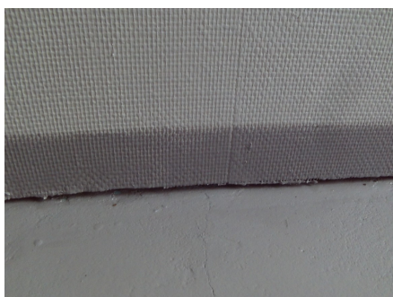
Ingen fuktsikring i overgang gulv og vegg.
