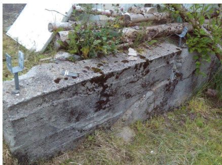
Skjevheter og sprekker.
