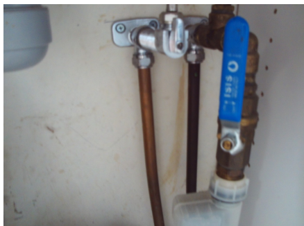
Rørøpplagg i kjøkkenbenken.
