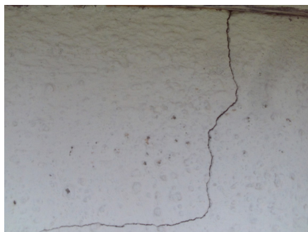
Noen mindre sprekk på ytterhjørne i mot terrasse.
