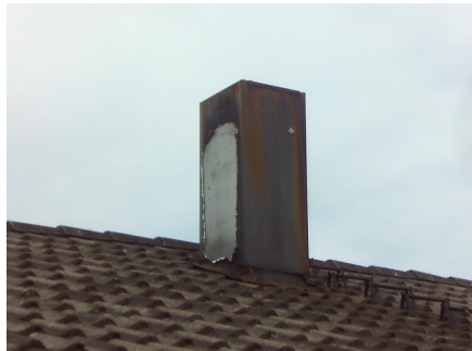
Belegg har løsnet på pipe hatt.
