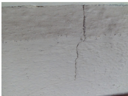
Noen riss enkelte steder.
