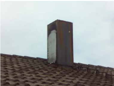
Belegg har løsnet på pipe hatt.
