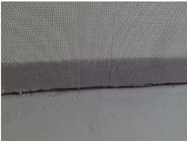
Ingen fuksikring i overgang gulv og vegg.
