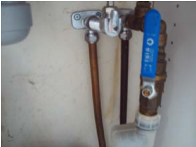
Røropplegg i kjøkkenbenken.
