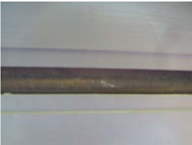
Gode luftespalter i gesimser.
