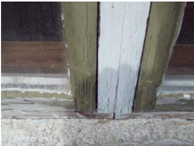
Bærer preg av alder og slitasje.
