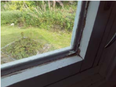
En del kondensmerker på innvendig karm og ramme.
