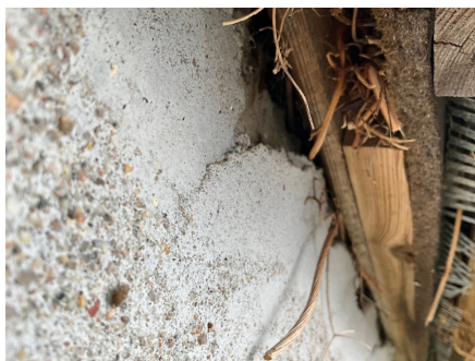
Åpninger inn bak vindtettingen.
