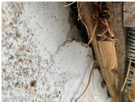
Åpninger inn bak vindtettingen.
