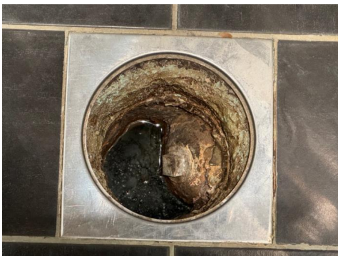
Eldre støpejernsluk i dusjsone.
