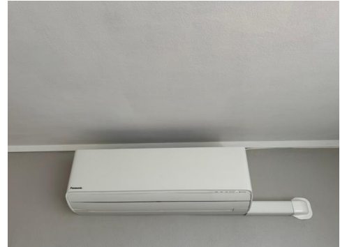
Varmepumpe med uttak i stue.
