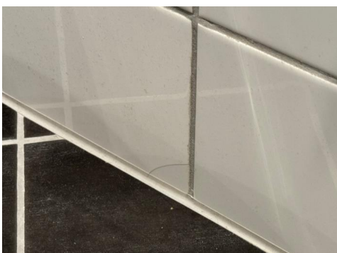
Sprekk i veggflis på høyre side av toalett.
